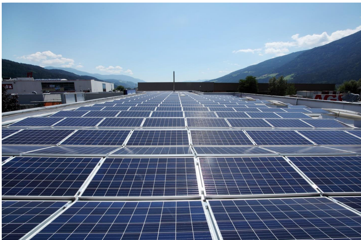
Foto 01.01: PV-Anlage Tauernpark Spittal, Foto: Barbara Krobath
